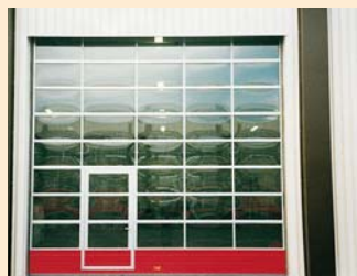
... Schlupftüre im 2. Feld von außen möglich
